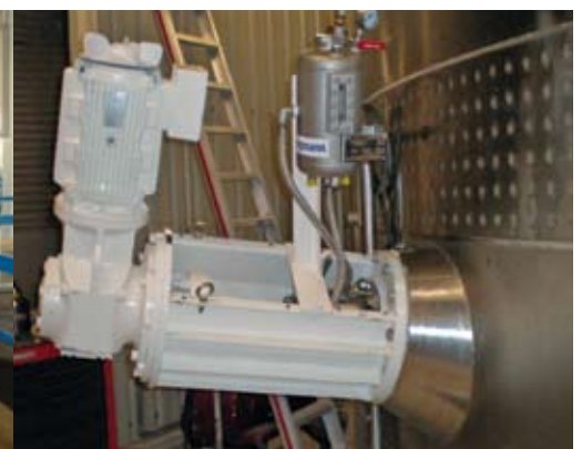
Agitateur entrée latérale – stockage vins
