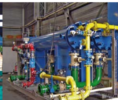
Unité de dilution d'acide sulfurique
