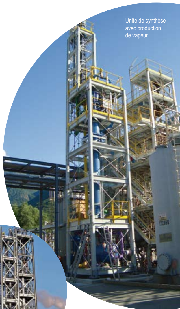
Unité de synthèse HCl avec récupération de chaleur
